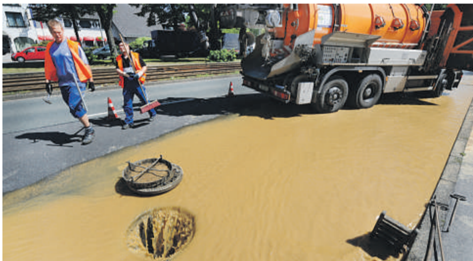
Nach einem Wasserrohrbruch musste die B1 in Richtung Unna gesperrt werden. Foto: Ralf Rottmann
